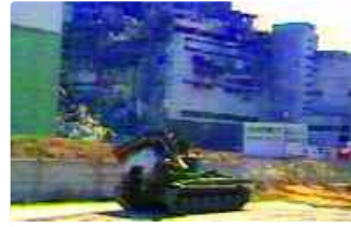
Schon kurz nach dem Unfall sind die Aufräumarbeiten in vollem Gange
