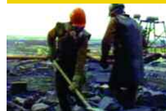
5.000 Männer mussten für 90 Sekunden auf das havarierte Kraftwerk
