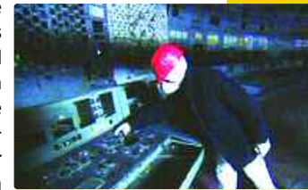
Die Leitwarte des Blocks 4. An dieser Stelle war die Notabschaltung. Hier kämpften die Ingenieure vergeblich darum, den außer Kontrolle geratenen Reaktor zu stoppen
